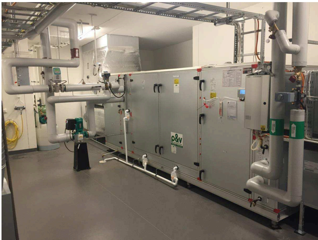
Figur 2 Finnboda Hamnplans ventilationsaggregat LB03 med HSB-FTX. Rördragningen från borrhålen med värme- och kylmängdsmätare ses upp till vänster i bilden.
