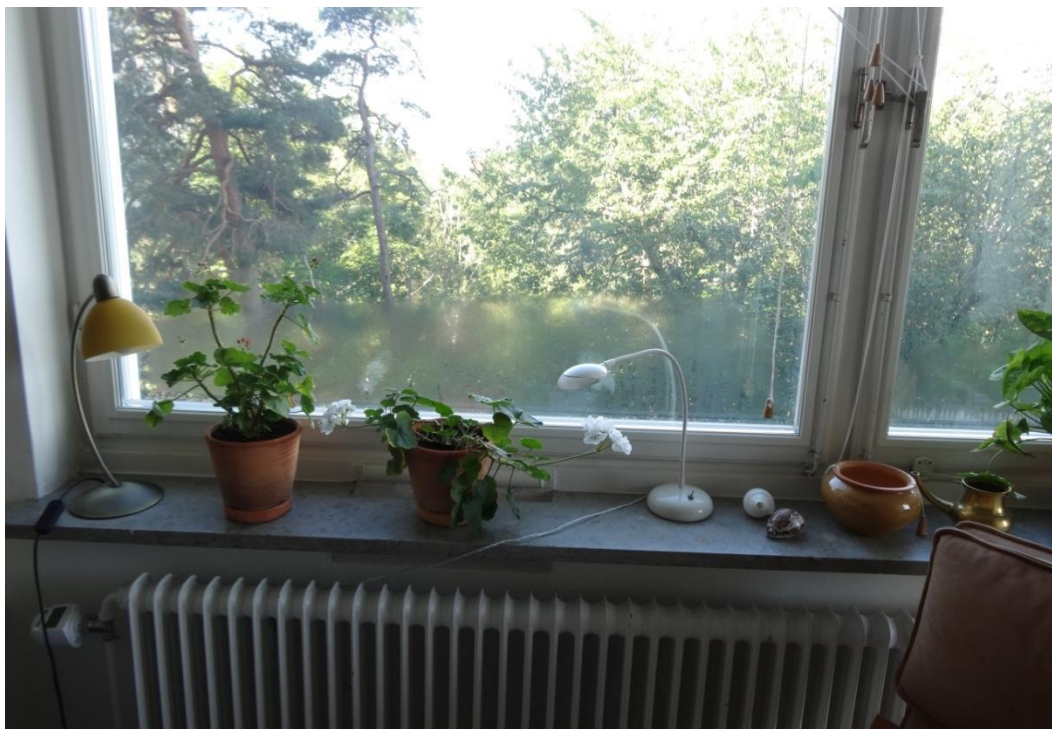
Figur 10 Isolerruta uppbyggd på insidan av innerrutan. Man kan i bilden se en extra list på glaset närmast bågen. Nedredelen av glaset har kondens på utsidan, vilket är en indikation på en välisolerat fönster.
