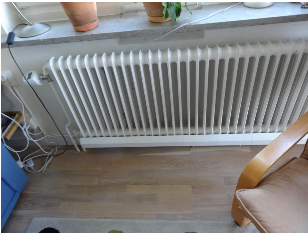
Figur 11 Elementfläktar är monterade i underkant av radiatorerna för att öka den konvektiva värmeavgivningen från radiatorn. Ett svagt ljud hörs från fläkten. Ljudnivåerna i rummen är ej uppmätta.
