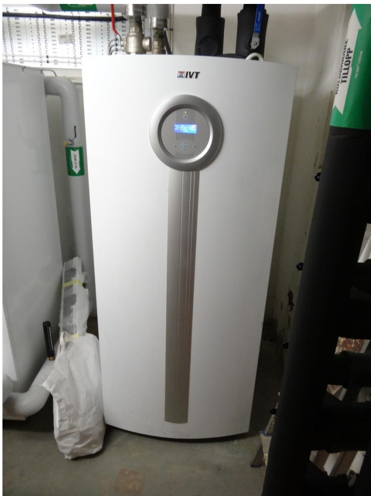
Figur 14 Bergvärmepump, IVT D43, installerad i källaren
