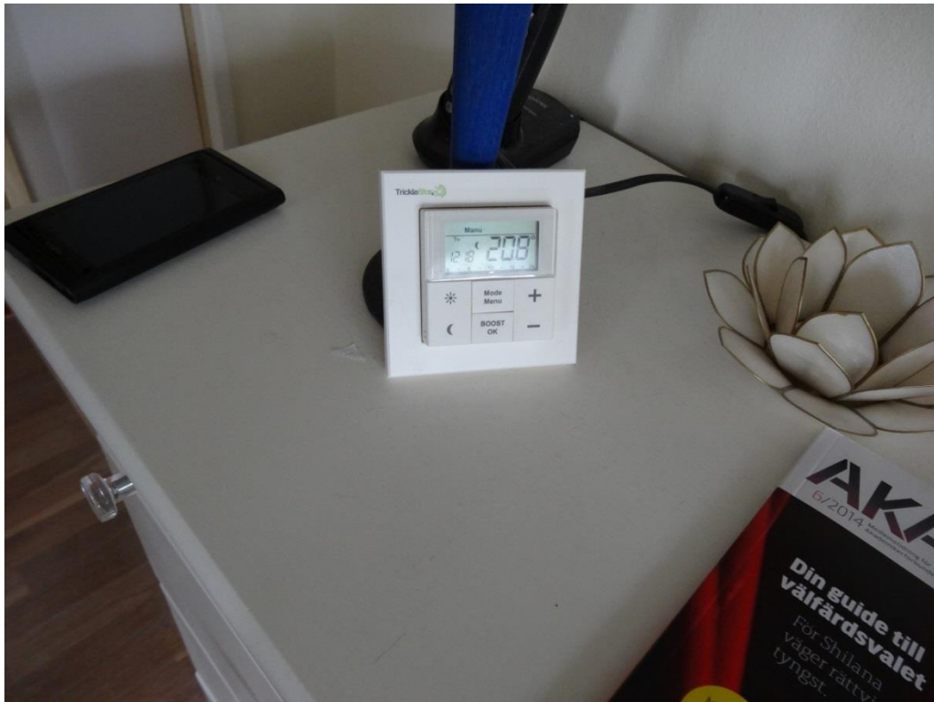
Figur 13 Temperaturstyrning av den digitala radiatortermostaten
