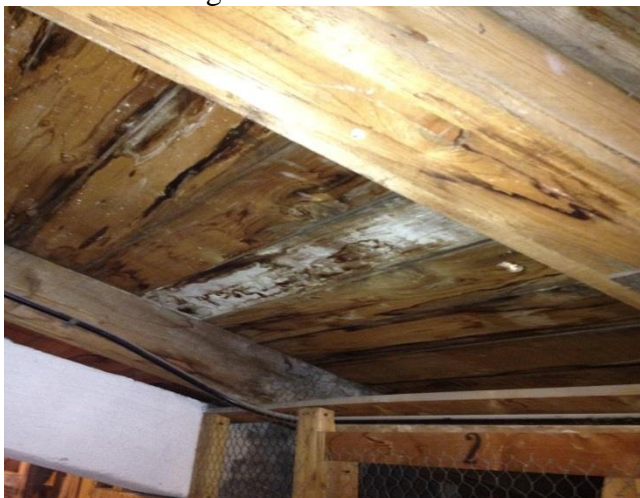
Kallvind. Ytliga skador från fukt
