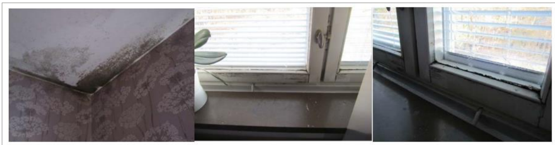
Figur 18 Lägenhet i Västerhaninge, resultat av fukt och bristande ventilation. Svartmögel på väggar, tak och fönster.
