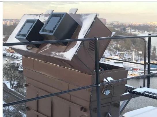
Clean-Air modul i serviceläge på Skorsten L som betjänar kök och badrum. Serviceläget används t.ex. vid kontroller, filterbyten eller rensning.
