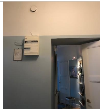
Tilluftsdorn i lgh 1002. Ingen kanaldragning
