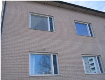
Bild 3 Ö:a Radens fönster är skamfilade, gårdsida
