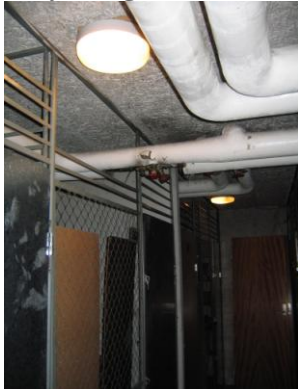
Bild 23 Styrbordsgatan 2-4 närvaro- och ljudstyrd belysning, ett provhus
