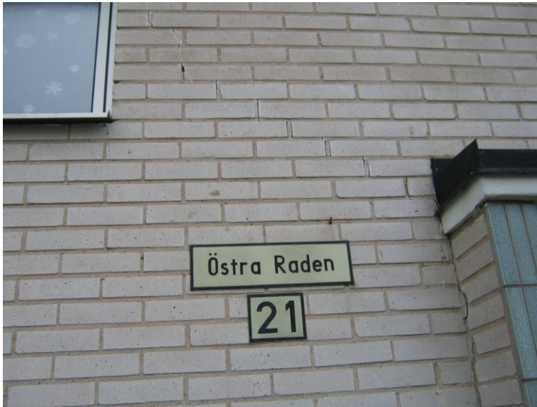
Bild 13 Tegelfasaderna på Östra Raden spricker
