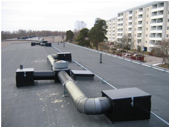
Bild 17 Ventilation på taket, Ö:a Raden
