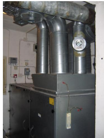
Bild 18 Ventilation på Babords- och Styrbordsg
