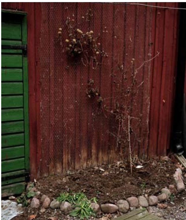
Rabatter direkt mot fasaden skadar träpanel och puts.
