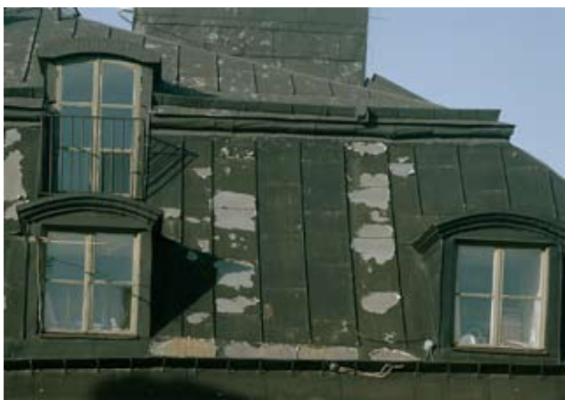
Plåttak med plastbeläggning som flagar. Taket åtgärdas vanligen först om det blir skadat av exempelvis rost.
