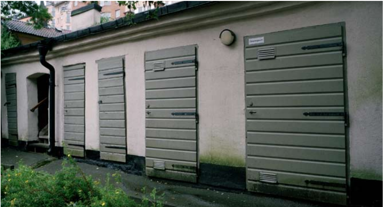
Även förradslängor och uthus är viktiga för helhetsbilden. Denna används nu för cyklar, hushållssopor och grovsopor. Soprummens krav på luftning har lett till nya luftningsventiler. Lilla Skinnarviksgränd 6.
