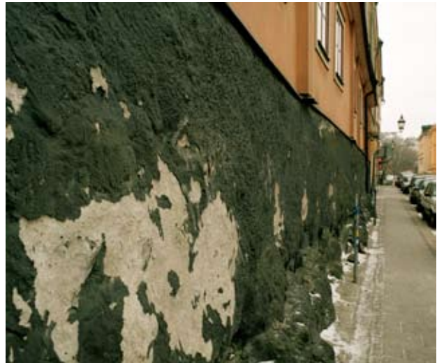
Saltutfällningar på en beckmålad stenmur.
