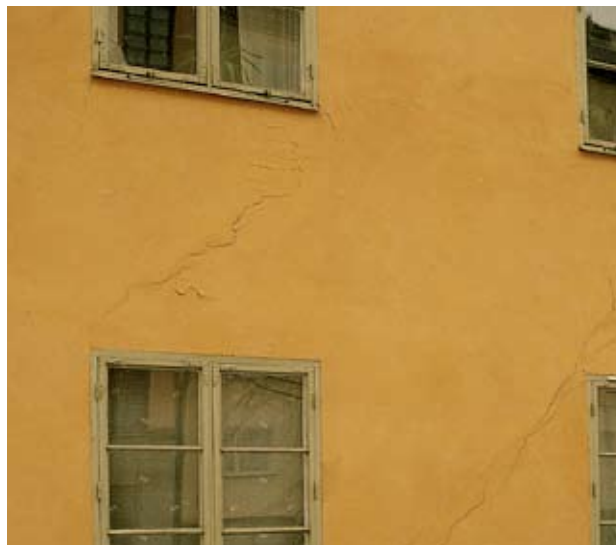
Sättningar syns i fasaden som diagonala sprickor. Dessa uppstår vanligen i partierna under fönstren, som är den murade konstruktionens svagaste delar.
