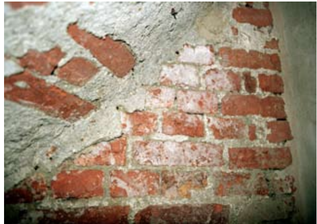
Fukt har lett till saltutfällningar och att både puts och tegel vittrar sönder.
