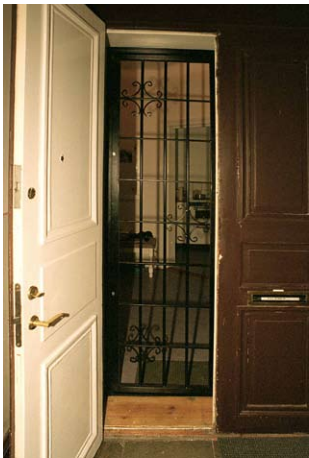
Den befintliga brandförstärkta lägenhetsdörren har kompletterats med en gallergrind.
