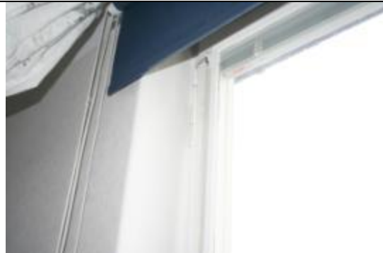
Figure 3a. Läckage vid genomföring för persiennstyrning.
