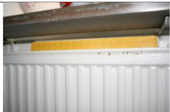
Bild 2b. Uteluftsdon bakom radiator tätades provisoriskt under provningen.
