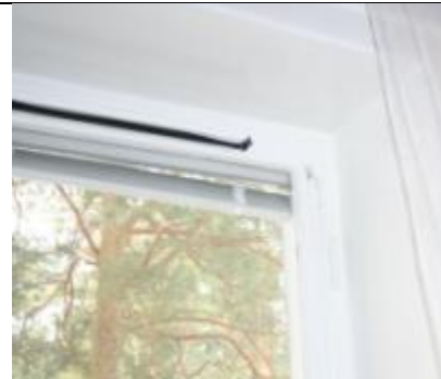
Bild. Läckage vid genomföring för persiennstyrning i fönsterbåge.
