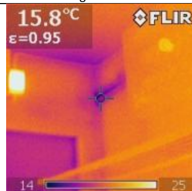
Bild 8b. Läckage vid genomföring för elledning.
