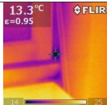
Bild 5b. Läckage genom skarv i fönsterkarm.
