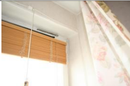
Bild 3a. Sovrum, läckage mellan fönsterbåge och karm.
