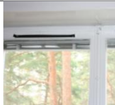
Bild. Läckage i springa mellan uteluftsdon och fönsterbåge.
