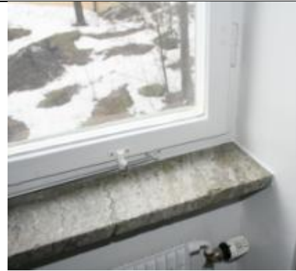
Bild. Otätet mellan fönsterbåge och fönsterkarm.
