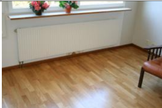
Bild 2a. Vardagsrum. Nytt laminatgolv har lagts in som döljer två tilluftsöppningar för gammalt tilluftssystem som tagits ur drift i samband med ombyggnad till F-system (Frånluftssystem).
