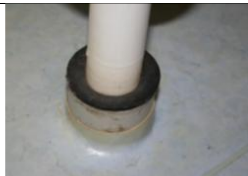
Bild 16b. Badrum. Läckage via otäthet mellan avloppsrör från tvättställ och avloppsrör i bjälklag. Detta är troligen förklaring till kännbar avloppslukt i badrum trots vattenfyllda vattenlås.
