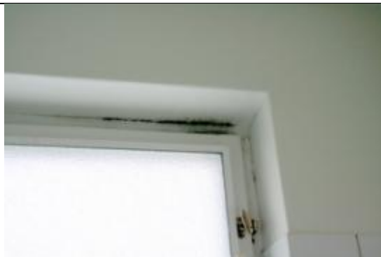
Bild 2a. Badrum, läckage mellan fönsterbåge och karm.
