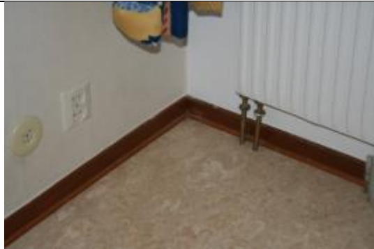
Bild 9a. Sovrum. Läckage i hörn mellan golvsoclel och golv.
