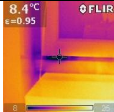
Bild 4b. Läckage mellan fönsterbåge och karm.
