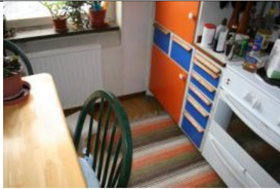
Bild 4a. Kök, läckage mellan golvsoclel och golv.
