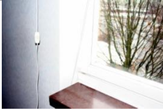
Bild 4a. Läckage mellan fönsterbåge och karm.
