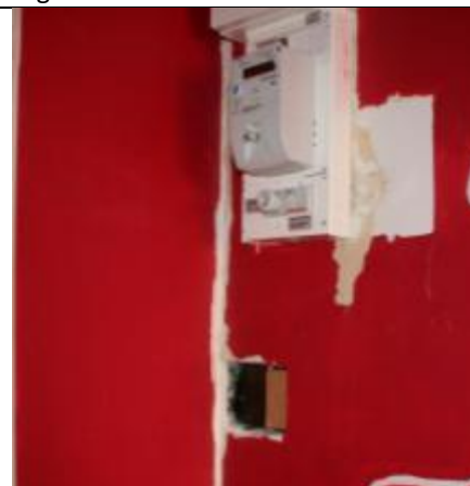
Bild 7b. Ett mindre luftläckage konstaterades i elskåp.
