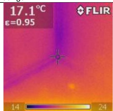
Bild 10b. Sovrum. Läckage i hörn mellan golvsoclel och golv.
