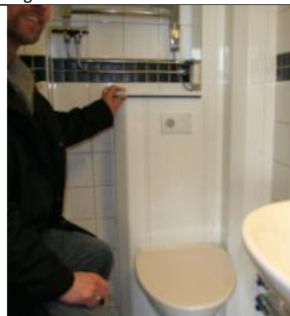
Bild 7a. Genom att glänta på lock till WC/schakt kunde luftläckage konstateras med varmtrådsanemometern. I spalten uppmättes 0,3 m/s.
