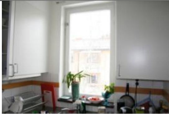
Bild 4a. Kök, läckage mellan fönsterbåge och karm.
