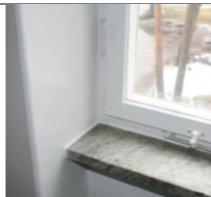
Bild. Otäthet mellan fönsterbåge och fönsterkarm.
