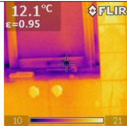
Bild 3b. Läckage vid badrumsfönster, mellan båg och karm.
