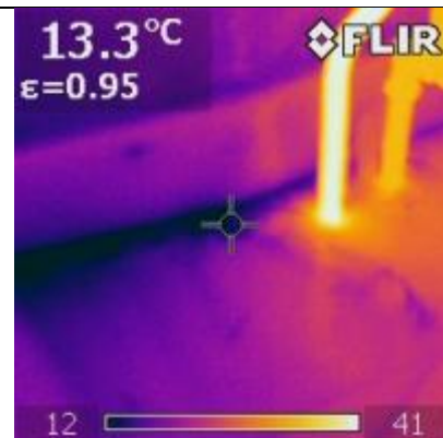
Bild 4b. Läckage mellan golvsockel och golv.
