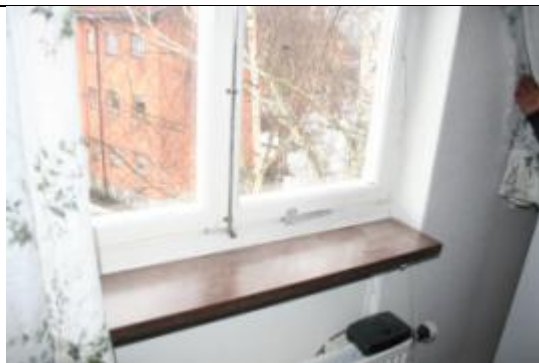
Bild 2a. Läckage mellan fönsterbåge och karm.
