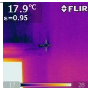
Bild 14b. Kök. Läckage mellan fönsterbåge och karm.
