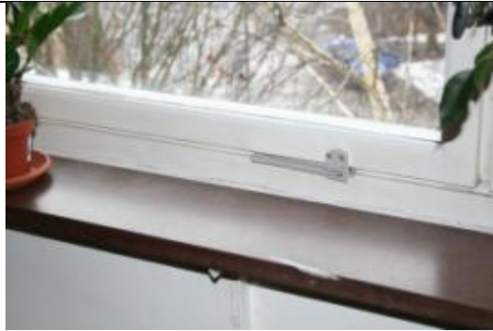
Bild 8a. Läckage genom spricka i fönsterkarm.
