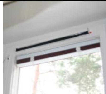
Bild. Läckage i springa mellan uteluftsdon och fönsterbåge.
