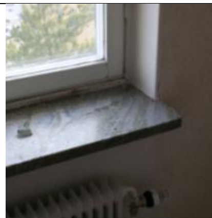
Bild 5b. Otäthet mellan fönsterbåge och karm.
