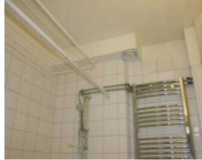
Bild 8b. Frånluftsdon i badrum samt horisontell kanal till frånluftsdon i vardagsrum.
