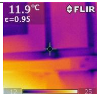
Bild 6b. Läckage mellan fönsterbåge och karm.
