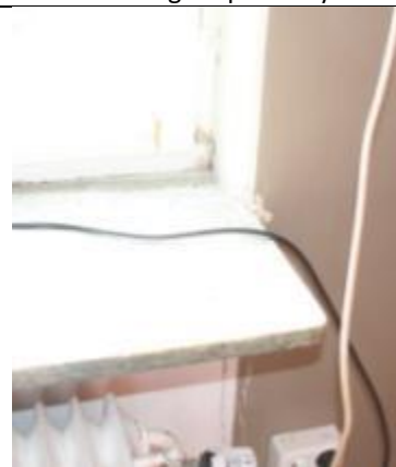
Bild 3b. Otäthet mellan fönsterbåge och karm.
