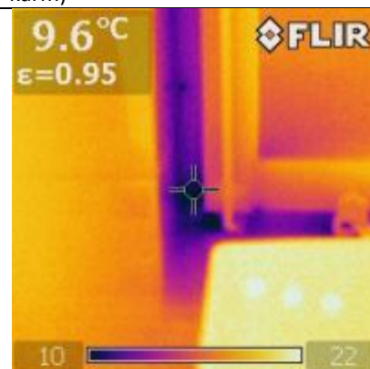
Bild 7b. Läckage vid fönster (mellan båge och karm)
