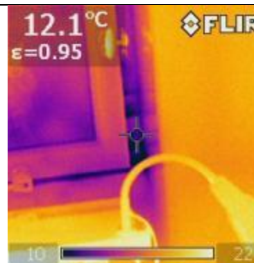
Bild 5. Läckage mellan fönsterbåge och karm.
