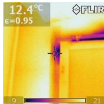
Bild 4b. Läckage mellan fönsterbåge och karm.
