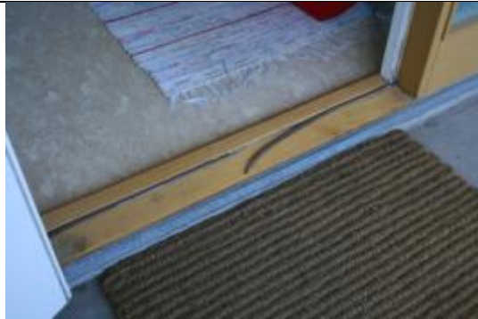
Bild 17. Ytterdörr. Läckager pga trasig tätningslist.
