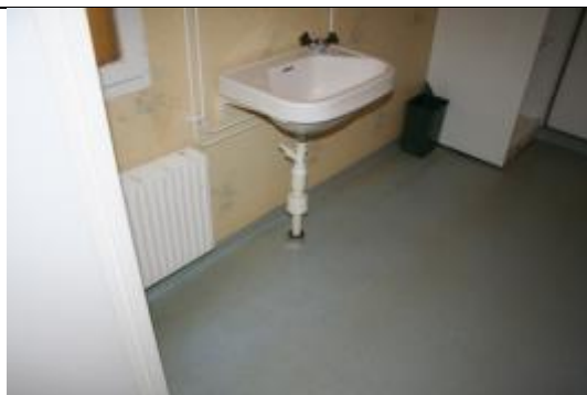
Bild 16a. Badrum. Läckage via otäthet mellan avloppsrör från tvättställ och avloppsrör i bjälklag. Detta är troligen förklaring till kännbar avloppslukt i badrum trots vattenfyllda vattenlås.
