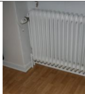
Bild. Sovrum, otäthet mellan golvsoc­kel och golv.
