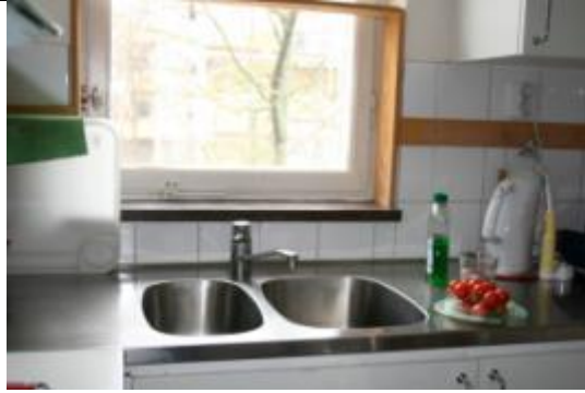
Bild 8a. Kök, läckage mellan fönsterbåge och karm.
