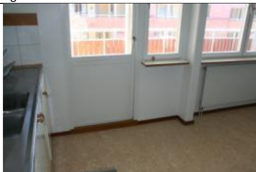
Bild 12a. Kök. Stort läckage mellan balkongdörr och dörrkarm.
