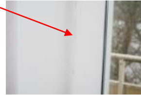
Bild 6c. Spricka i dörrkarm.
