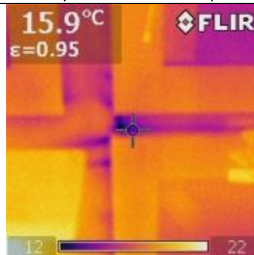
Bild 3b. Läckage mellan fönsterkarm och båge.
