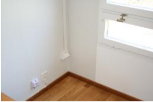
Bild 5a. Vardagsrum. Läckage i hörn mellan golvsoclel och golv.
