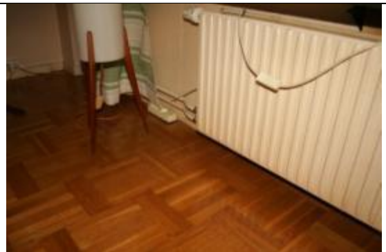
Bild 2b. Vardagsrum. Det största läckaget noterades i skarv mellan yttervägg och golv.
