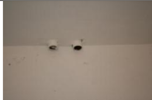
Bild 6b. I klädkammare finns 2 st kapade rör vid tak.
