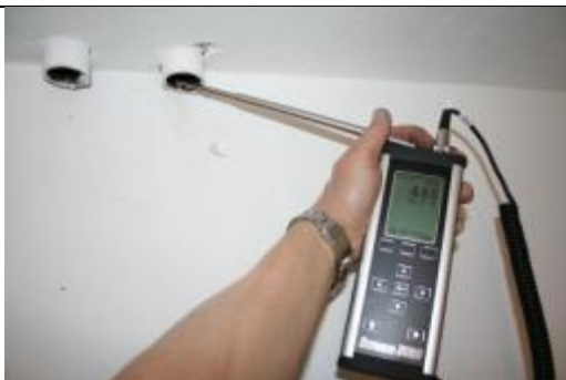
Bild 8a. I rörmyrning mättes lufthastigheter kring 5 m/s vid undertryck 50 Pa. Lufttemperaturen mättes till ca +14°C vilket indikerar att det snarare är uteluft än överluft från annan/andra lägenheter.
