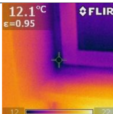
Bild. Otäthet mellan fönsterbåge och fönsterkarm.
