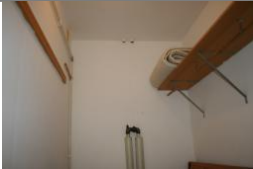
Bild 6a. I klädkammare finns 2 st kapade rör vid tak.
