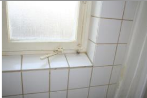
Bild 5a. Läckage mellan fönsterbåge och karm.
