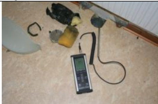
Bild 11a. Tilluftsdon i sovrurn var provisoriskt tätat med glasull och skumplast. Vid mätning med tillfälligt borttagen tätning mättes ca 4 m/s i donöppningen och lufttemperaturen till ca +20°C vilket indikerar att det är överluft från andra lägenheter.
