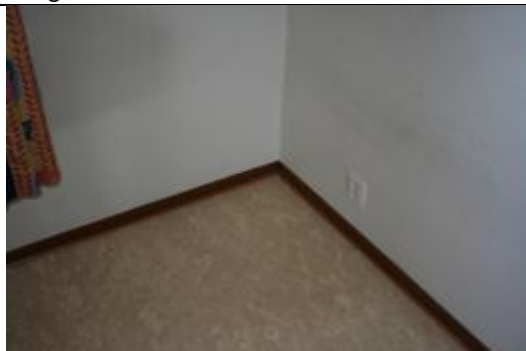
Bild 10a. Sovrum. Läckage i hörn mellan golvsoclel och golv.
