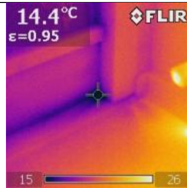
Bild 6b. Läckage mellan fönsterparti och golv.
