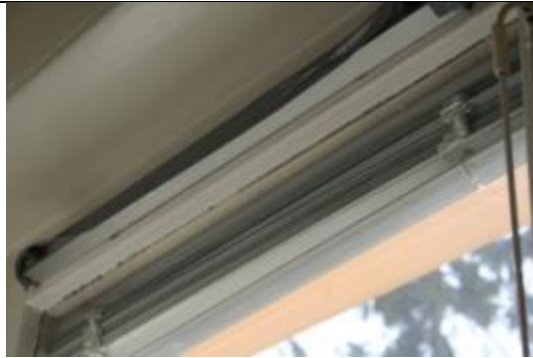
Bild 4a. Läckage mellan uteluftsdonets undersida och fönsterbåge.
