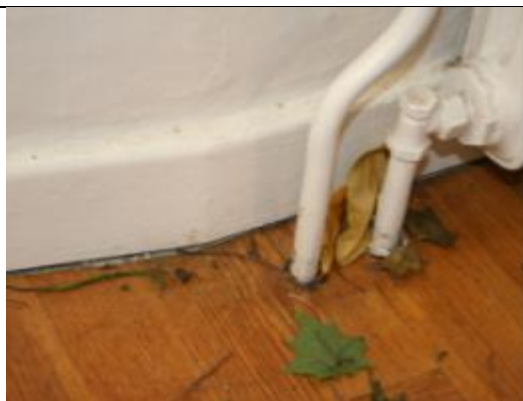
Bild 4a. Läckage mellan golvsockel och golv.
