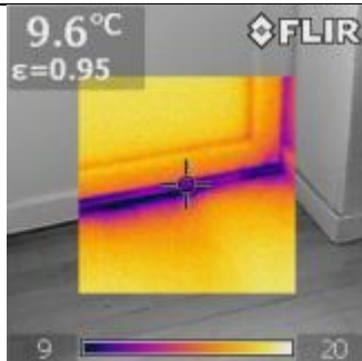
Bild 7a. Balkongdörr, läckage mellan tröskel och golv.
