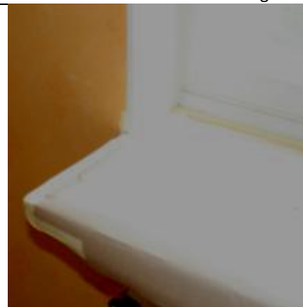
Bild 4b. Otäthet mellan fönsterbåge och karm.
