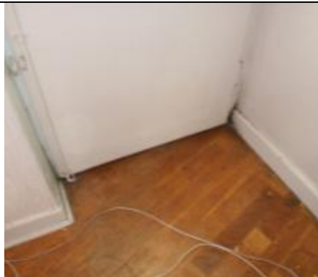
Bild 3a. Läckage vid balkongdörr (mellan båg och karm/tröskel)
