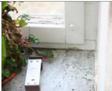
Bild 6a. Läckage vid fönster (mellan båge och karm)
