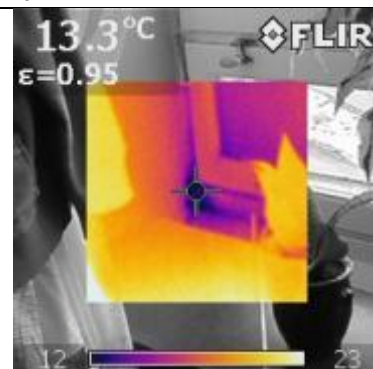
Bild 6b. Sovrum, läckage mellan fönsterbåge och karm.
