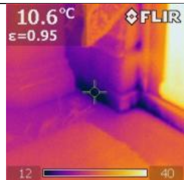
Bild 5b. Läckage genom yttervägg, i skarv mellan golvsockel och golv.
