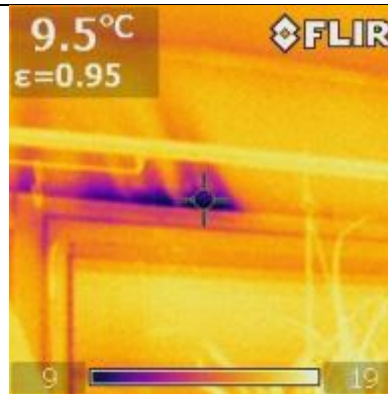
Bild 3b. Läckage genom yttervägg, i skarv mellan fönsterkarm och yttervägg.
