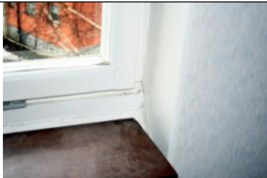
Bild 5a. Läckage genom skarv i fönsterkarm.
