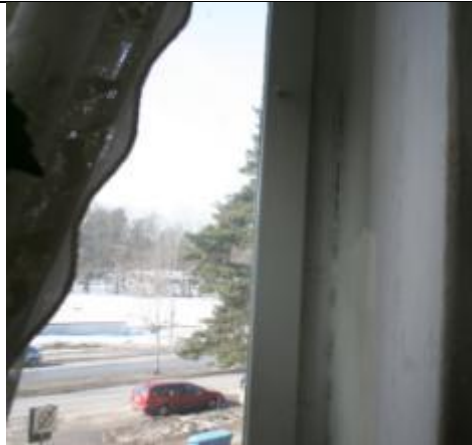
Bild 5a. Läckage vid fönster (mellan båge och karm)
