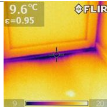
Bild 7b. Balkongdörr, läckage mellan tröskel och golv.
