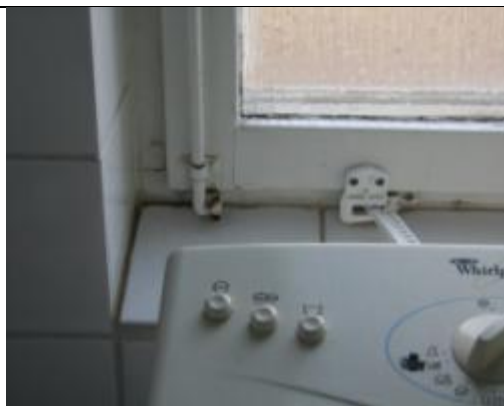
Bild 7a. Läckage vid fönster (mellan båge och karm)
