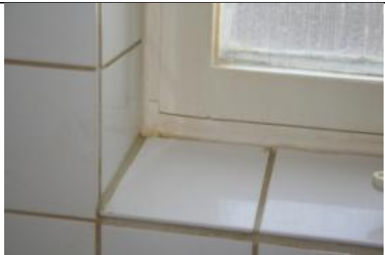
Bild 6a. Läckage mellan fönsterbåge och karm.
