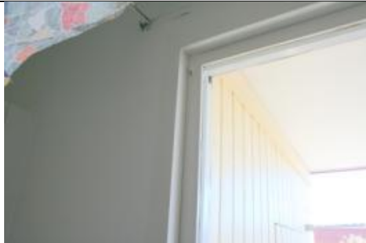
Bild 13a. Kök. Läckage mellan balkongdörr och dörrkarm.
