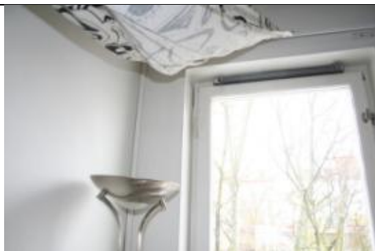
Bild 4a. Läckage mellan fönsterbåge och karm.
