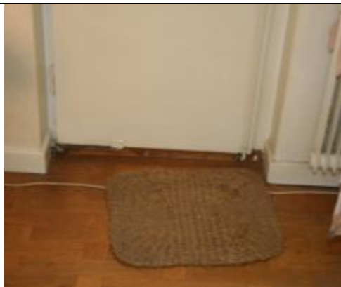
Bild 2a. Läckage vid balkongdörr.
