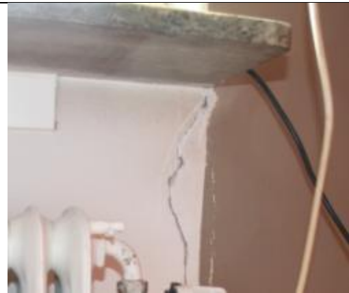
Bild 2b. Läckage i spricka i yttervägg.
