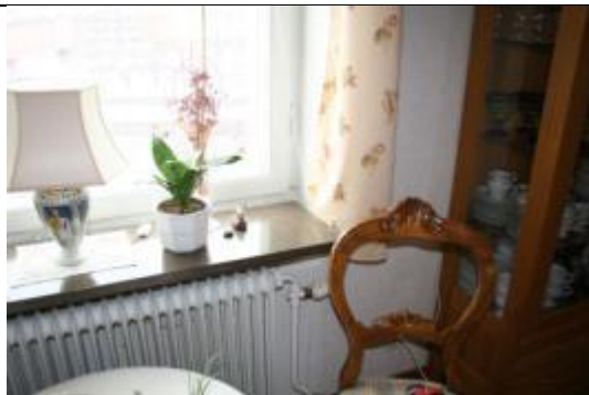
Bild 2a. Vardagsrum, läckage mellan fönsterbåge och karm.
