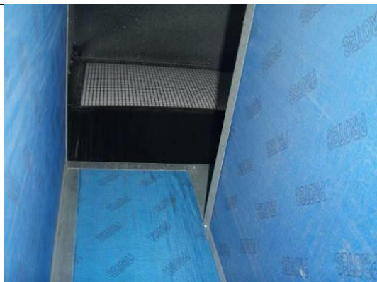
Figur 18 a: Takhuv med uteluftintag. Uteluftsgallret är nästan helt igensatt av snö och is. Platsbesök 29/12-15.
