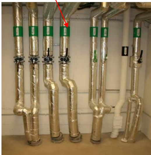
Bild 8. Från fjärrvärmeundercentral går värmekulvert med VS, VV och VVC till de 10 olika trapphusen.
