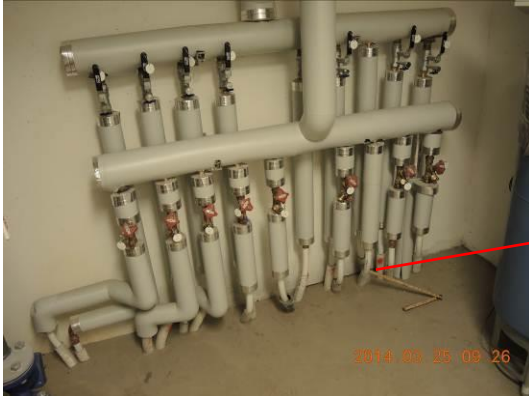
Bild 13. Värmefördelare i fjärrvärmeundercentral till totalt värmestammar är ingjutet i betongbjälklag på entréplan.
