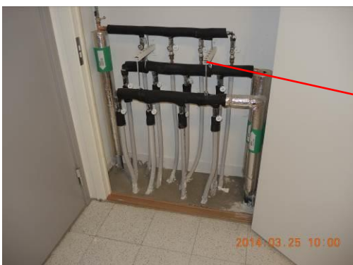
Bild 5. Våningsfördelare för VV, VVC och KV i trapphus på varje plan. Härifrån sker fördelningen till planets 4 lägenheter.
