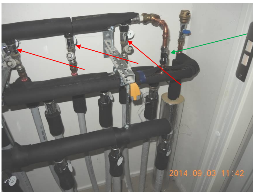
Bild 2.2. Rörschakt på översta våningen i trapphus. I VVC-slinga till varje lägenhet finns avstängningsventiler (röd pil) som möjliggör avstängning av planvisa VVC-flöden. Vid enbart cirkulation i vertikala VVC-stammar (ventil vid grön pil) blir väntetider på varmvatten längre än 30 sekunder som föreskrevs i äldre BBR. Bilden visar även gul Tinytag-logger som mäter temperatur på varmvatten högst upp i trapphus.
