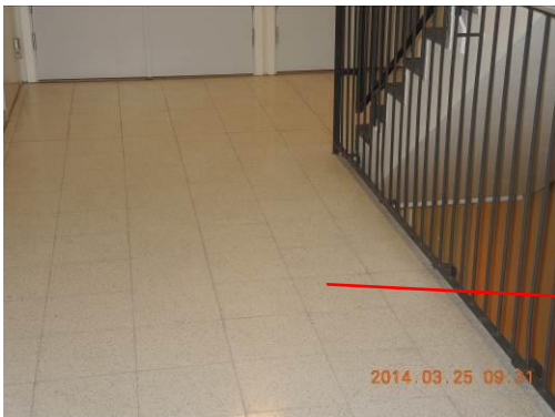
Bild 3. Värmeavgivning från VV och VVC i bjälklag.
