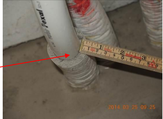
Bild 14. Isolertjocklek hos ingjutna värmerör i bjälklag verkar vara ca 10 mm.
