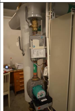
Bild 2.5. Värmemängdsmätare i VVC-krets. Undermätare till VV.VVC-pumpen har märkeffekt 5,8 – 59 W.
