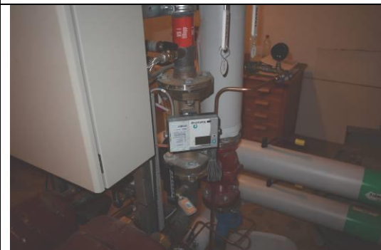
Bild 2.3. Värmemängdsmätare, Värmesystem VS1.
