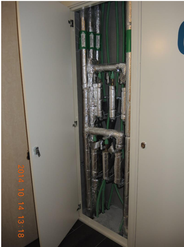
Bild 15. Rörschakt i trapphus med varmvatten, VVC och kallvatten. Från schaktet till tappställen i lägenheter dras rören i tomrör som utgör enda värmeisolering.
