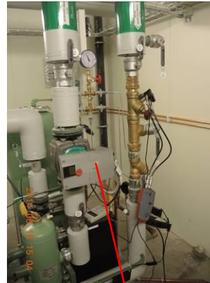
Bild 2. Loggning av flöde och temperaturer i värmesystem VS21.
