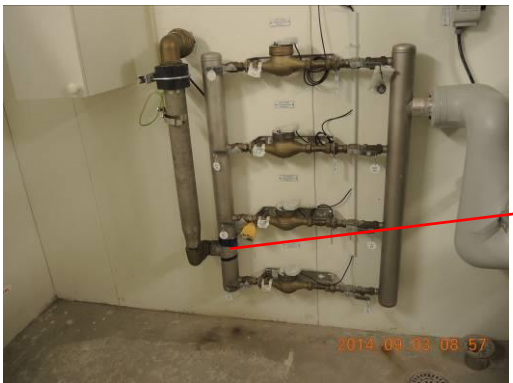
Bild 11. Loggning av ytemperatur på kallvattenrör.
