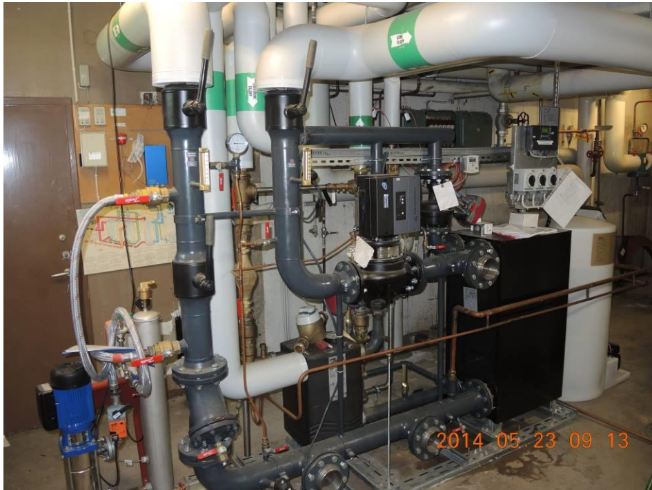
Bild 1.3. Huvudcentral, Valla Torg 83 betjänar Sandfjärdsgatan 91-101 och Valla Torg 65-89 samt undercentral placerad i Valla Torg 59.
