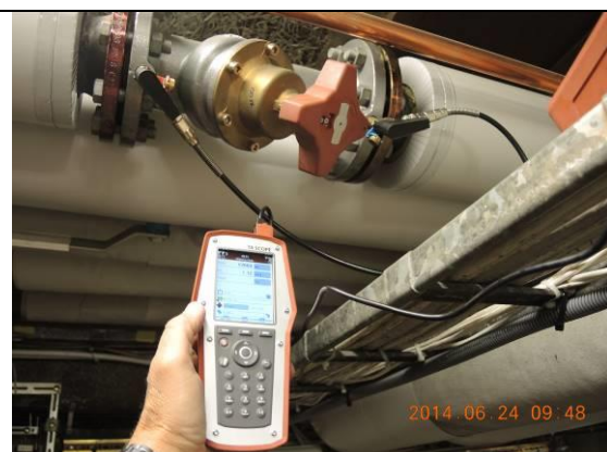
Bild 6. Mätning av värmevattenflöde i värmesystem VS1.
