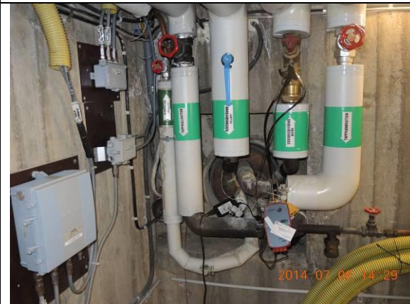
Bild 9. Loggning av flöde i värmesystem till radiatorer i quattrokulvert med 2VS1, VV+VVC.
