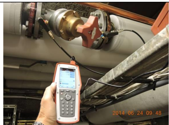
Bild 2.4. Mätning av värmevattenflöde i värmesystem VS1.
