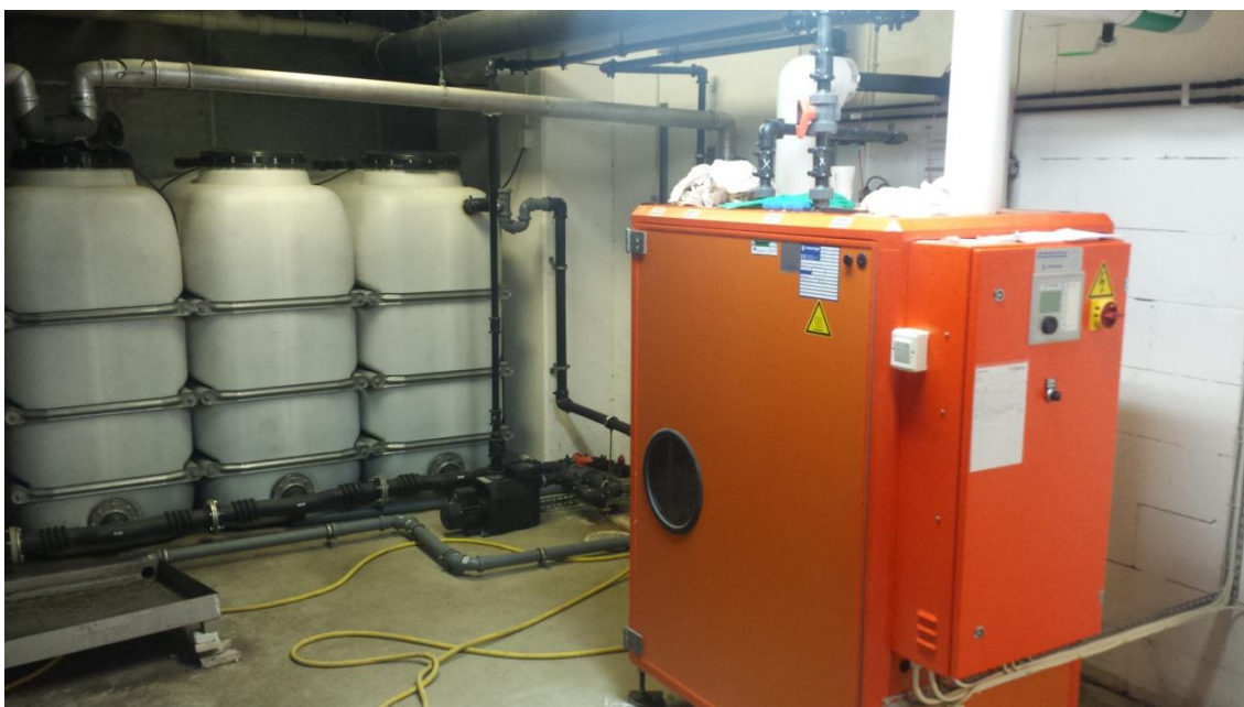
Sandsborgsbadet i Stockholm har en lösning med tankar och värmepump
