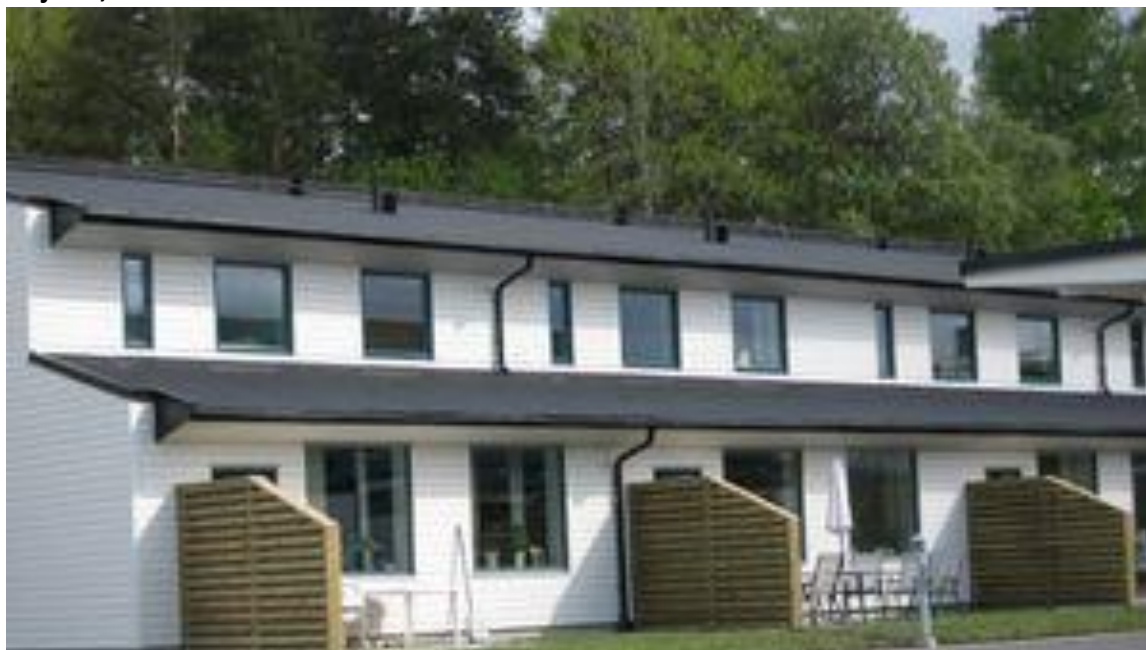
Solfångare för uppvärmning av varmvattnet (beräknas täcka minst 50 % av årsbehovet)
