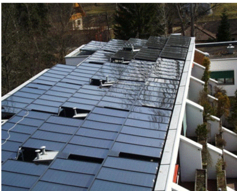
Figur 5.8 Solfångare integrerade i tak vid renovering av ett flerbostadshus.
