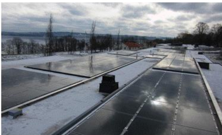
Figur 7.4 Solceller monterade platt på tak i Jönköping
