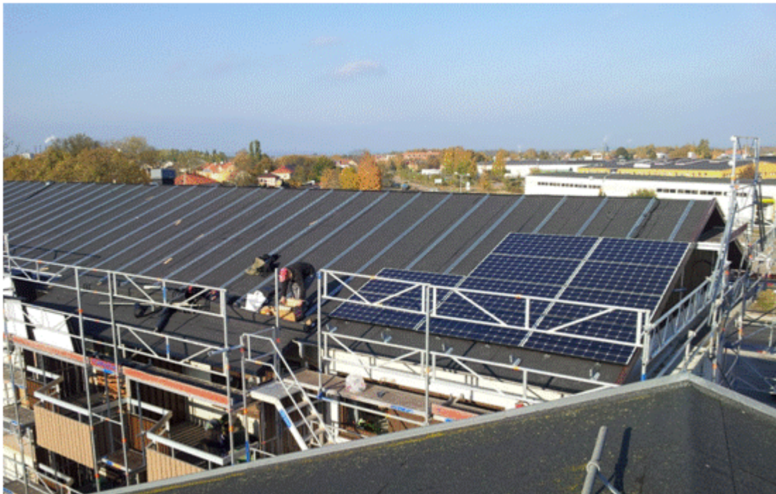
Figur 7.5 Solceller installerade på HSB byggnad
