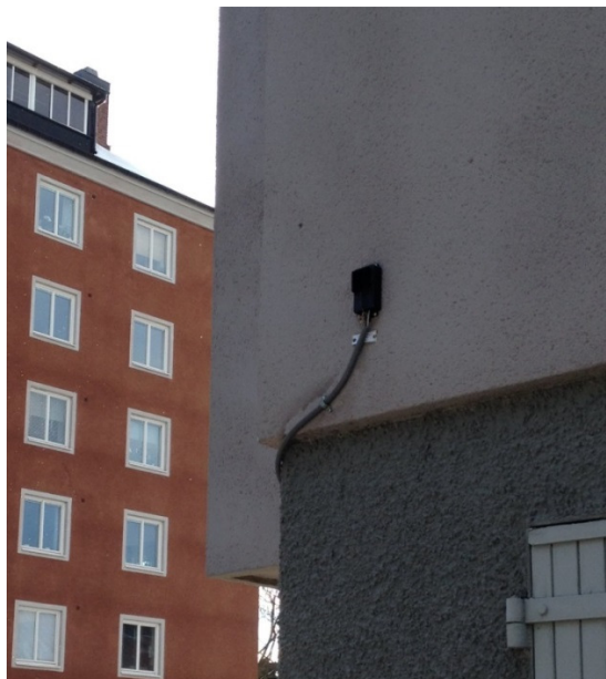
Figur 3 Temperaturkammare monterad på norrfasad utanpå en utetemperaturgivare
