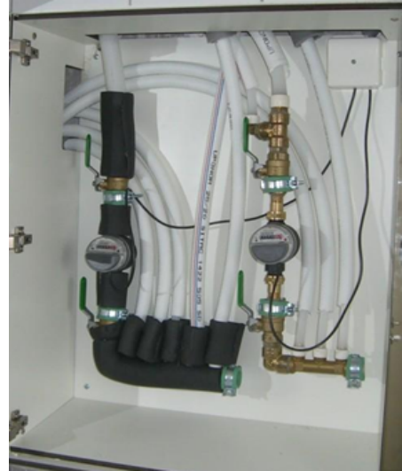
Figur 6 Nya tappvatteninstallationer med flödesmätare (mätarskåp i badrum).
