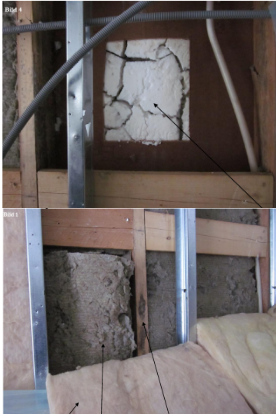
Figur 12 Uppbruten skadad yttervägg. I bilden till vänster framgår det krackelerade skummet vid pilen och till höger den gamla regelstommen med missfärgningar samt den nedvikta tilläggsisoleringen mellan plåtreglar.
