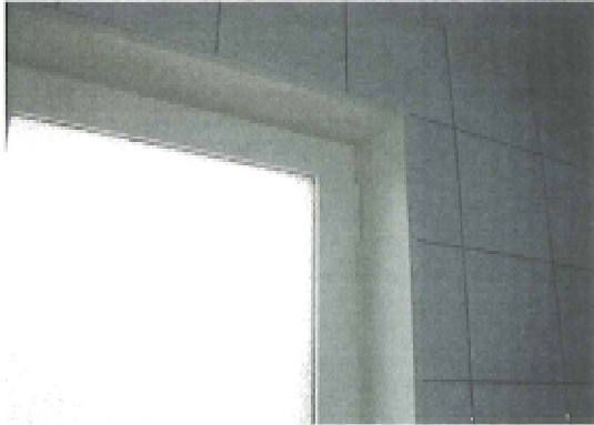
Luftläckning runt badrumsfönster.
