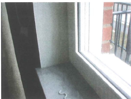
Luftläckning i fönstersmyg.
