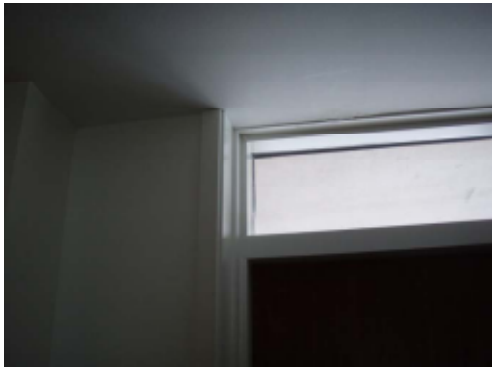
Luftläckning i karmens övre del
