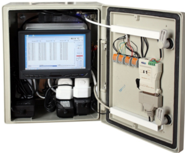
Figur 5 - Mät datorn monterad i apparatskåp.
