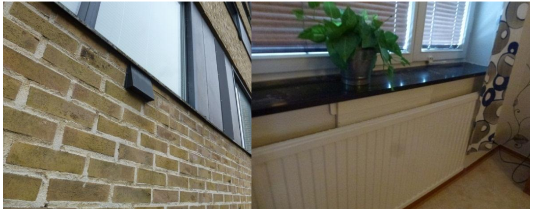
Figur 5. Tilluftsventil under fönster.
