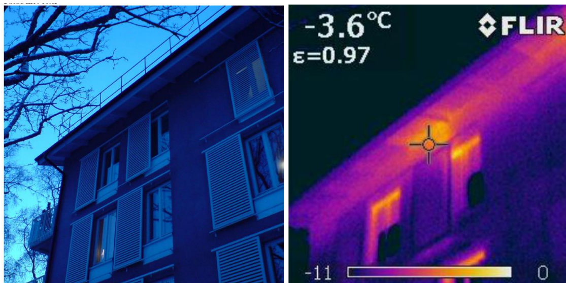
Figur 6 Fasad mot öster som visar förhöjd temperatur vid takfot.
