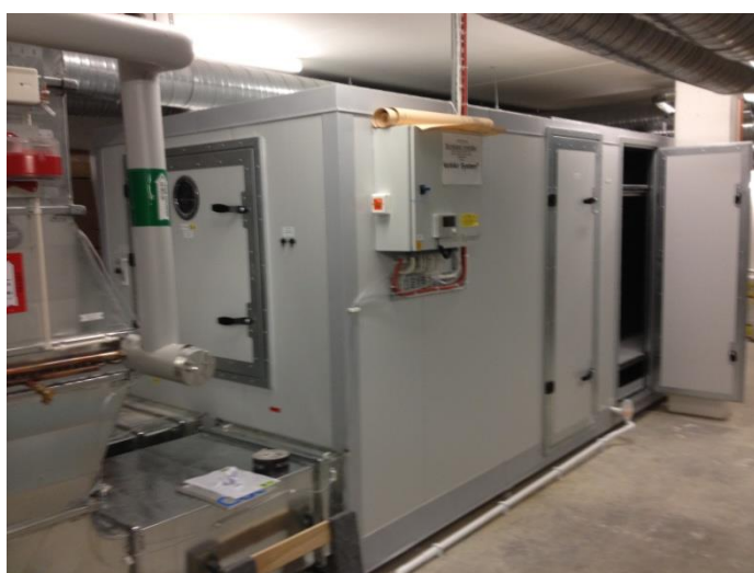
Ventilationsaggregat i källare.
