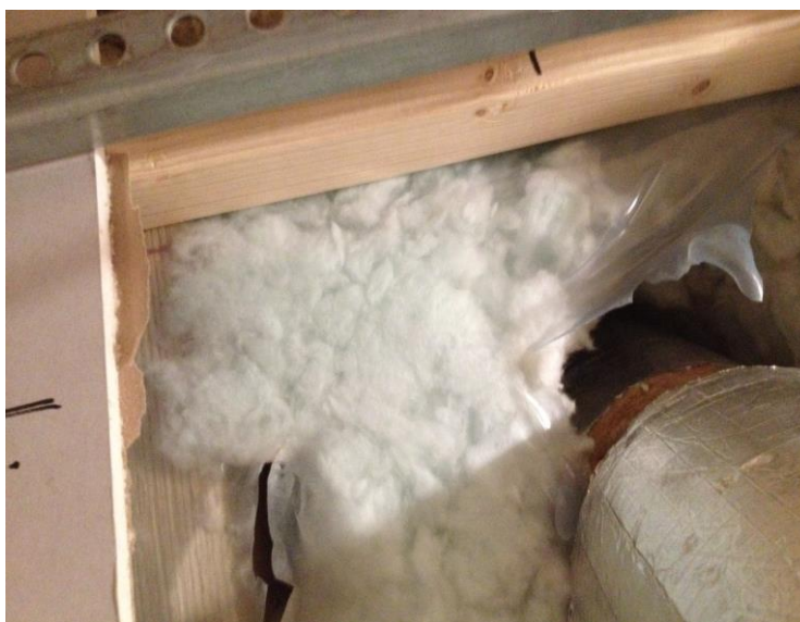
Figur 4 Otäthet vid installationsgenomföring för solfångarrör.
