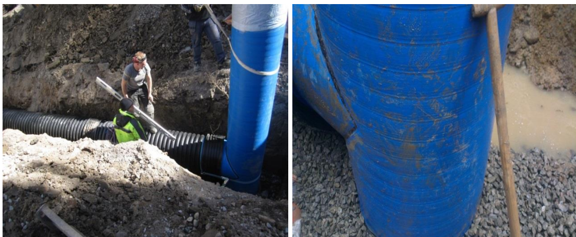
Vertikal del av tilluftkanal med dränering.
