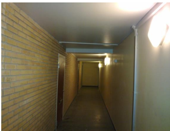
Tilluftskanal tvärs korridor på entreplan.
