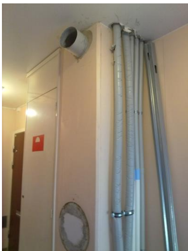
Utnyttjat sopnedkast för kanaldragning.
