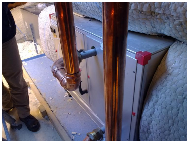
Värmeåtervinningsbatteri på vinden.
