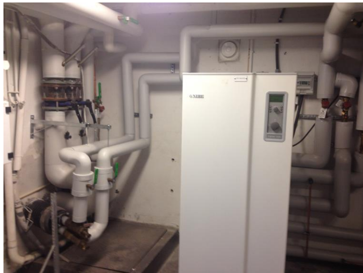
Undercentral med värmepump och kulvertanslutning.
