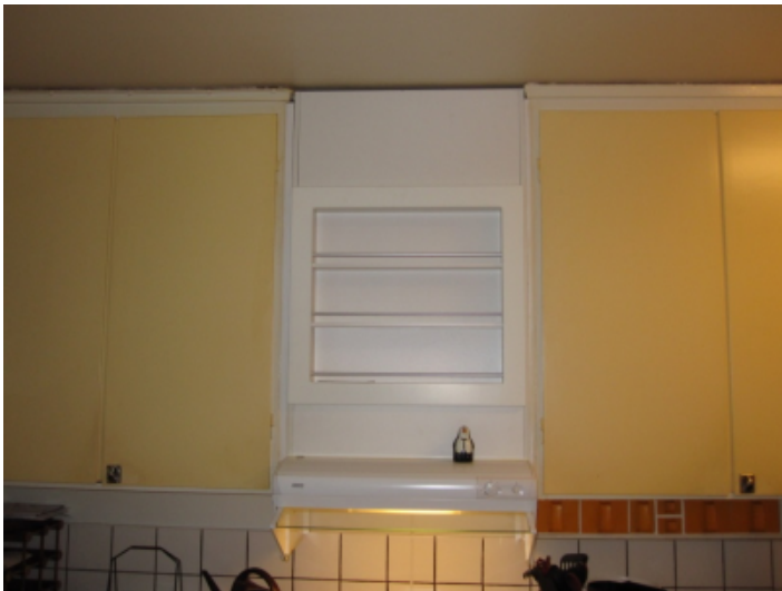
Klackvägen 11 Lgh 1866. Glipa mellan skåp och tak.
