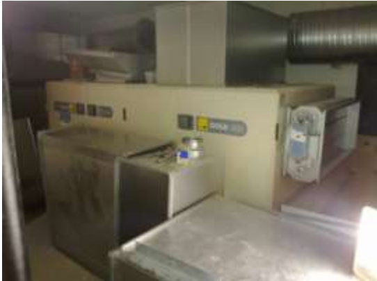
FTX-aggregat i källare
