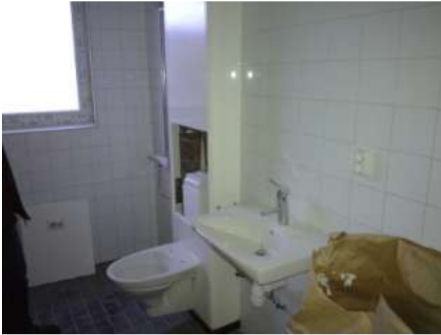
Nytt badrum med mätning av varm- och kallvatten.
