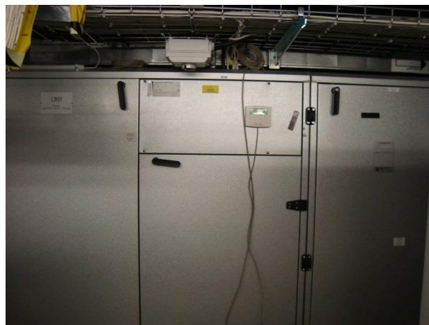
Nytt luftbehandlingsaggregat, Systemair.
