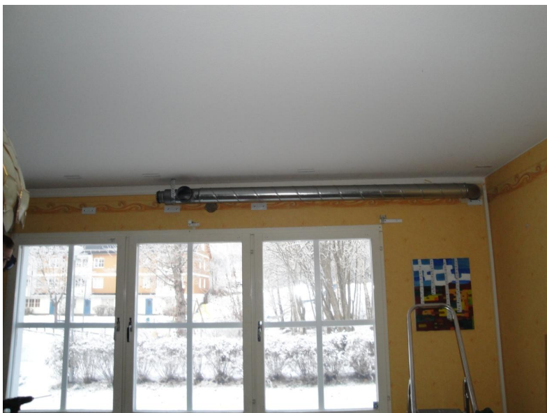
Bild 7. Montering av tilluftkanal i vardagsrum, kanalen fortsätter sen in i angränsande sovrum och avslutas med ett tilluftsdon, Jungfruvägen 9.
