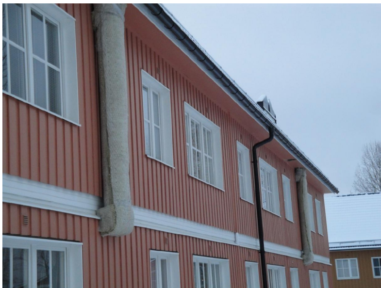
Bild 5. Tilluftskanaler före inklädnad, Jungfruvägen 9.
