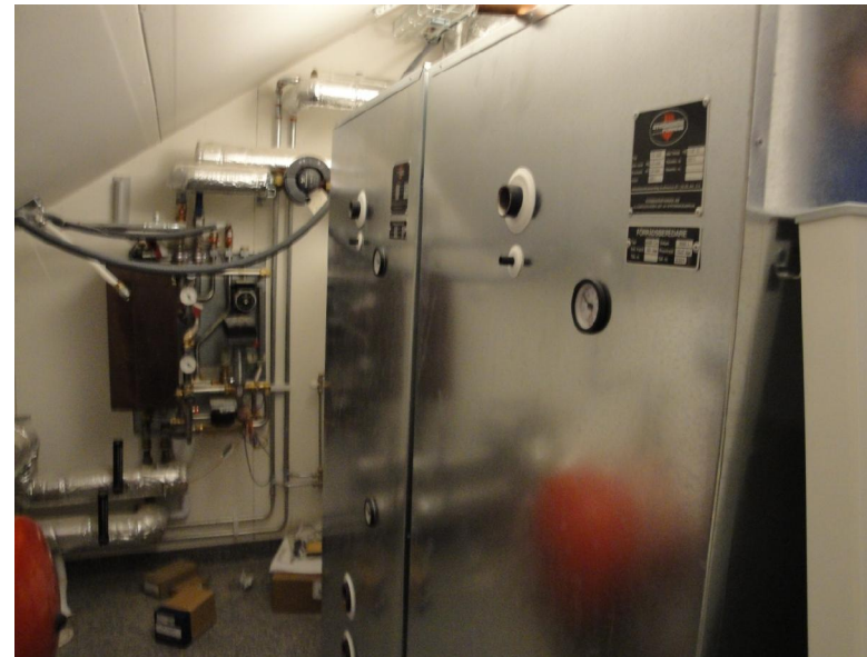
Bild 2. Värmepump och ackumulatortankar samt prefabricerad fjärrvärmväxlare på vägg, Jungfruvägen 137.
