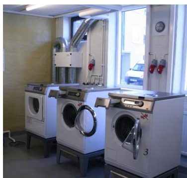
Ny tvättstuga med nya tvättmaskiner.
