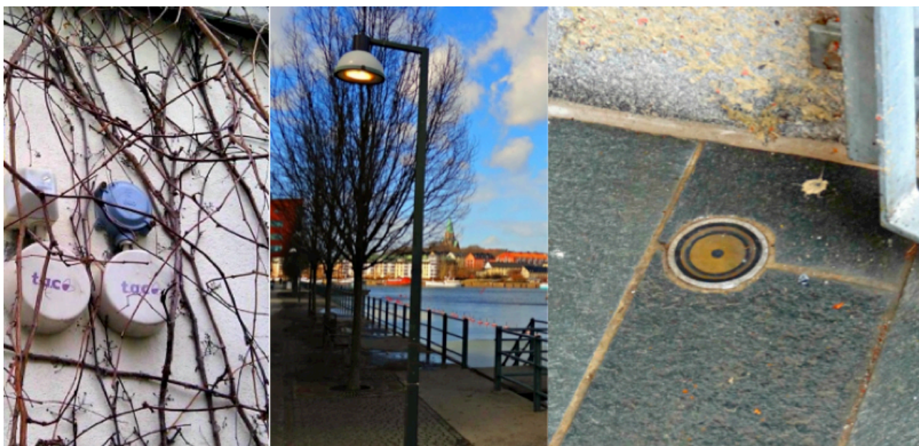
Figur 10. Felplacerade sensorer, belysning i dagsljus och temperatursensor i trottoaren som aktiverar värmeslingor med hög effekt
