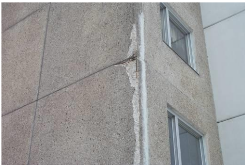
Figur 28. Orrholmen Karlstad. Betongelement som vittrat. Foto: Rolf Aleskog, KBAB.
