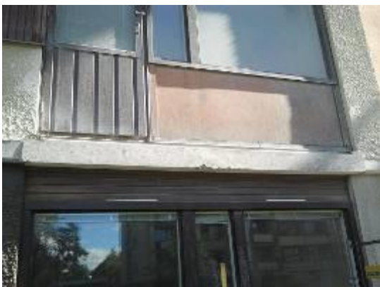
Figur 8. Rester av nedsågad balkong i Sättra Foto: Gavlegårdarna.
